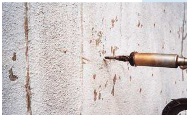
④ モルタルの浮き
