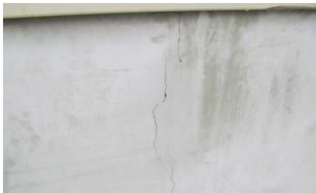
① ひび割れ
