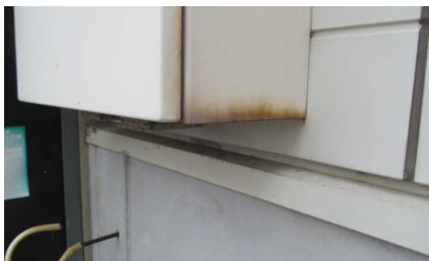
⑤ 鉄部の劣化
