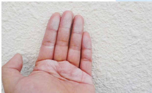
② 塗膜の劣化
